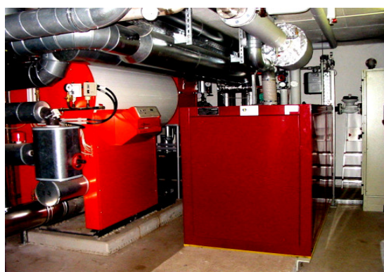
BHKW neben Heizkessel in der Heizzentrale „Maienweg/Suhrenkamp“
