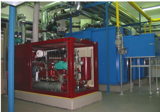
BHKW (geöffnet) neben Heizkessel in der Heizzentrale „Op'n Hainholt“
